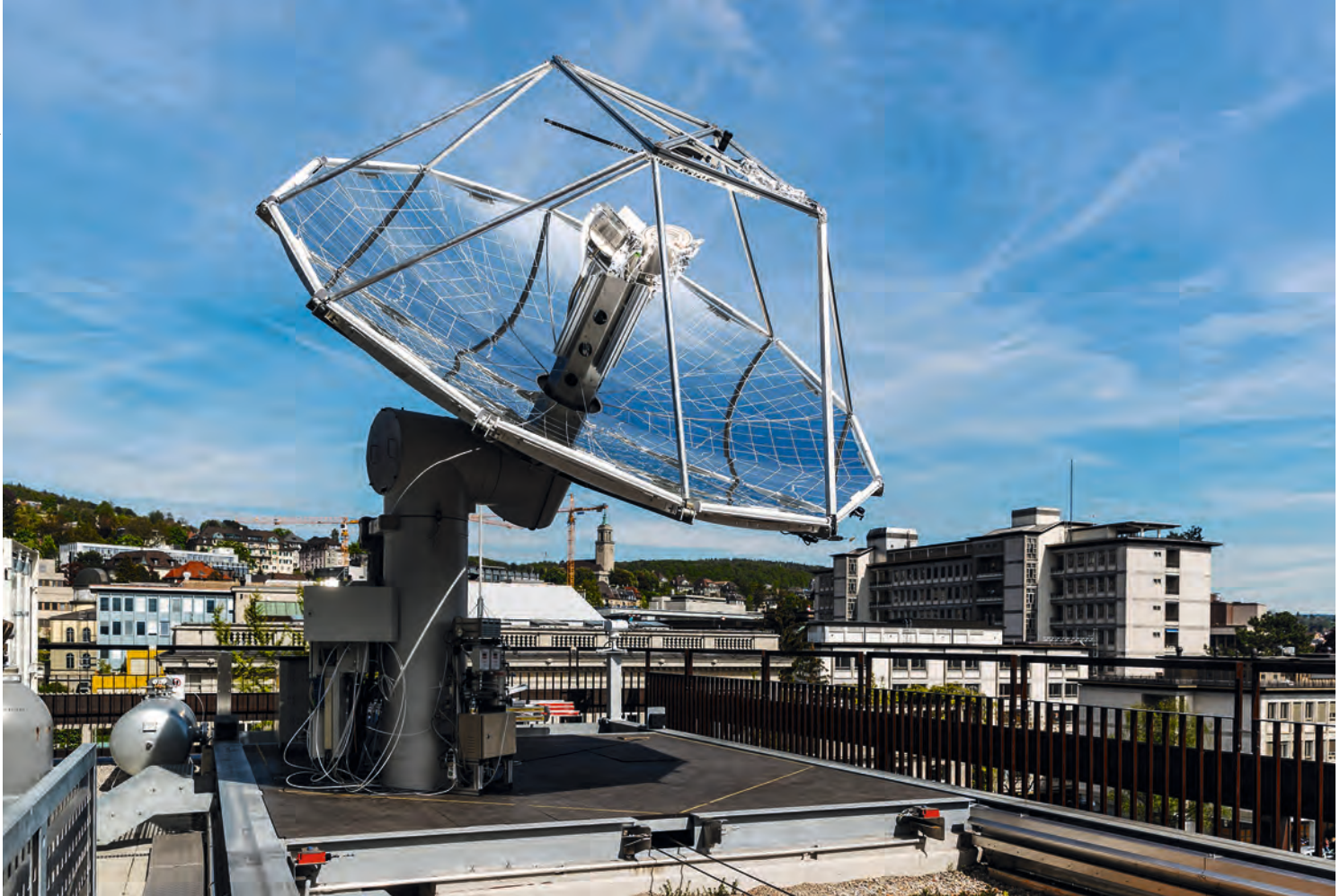
L'éblouissant prototype sur les toits de l'ETH de Zurich.
